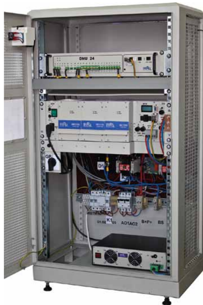
SN12/3300 sa pratećom opremom, dodatnom granom za punjenje baterija i uređajem za daljinski nadzor i upravljanje (DNU24) u kabinetu od 1000 mm
